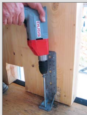
Fissaggio al solaio in legno mediante vite tutto filetto VGS (in alternativa si può utilizzare un bullone passante)
