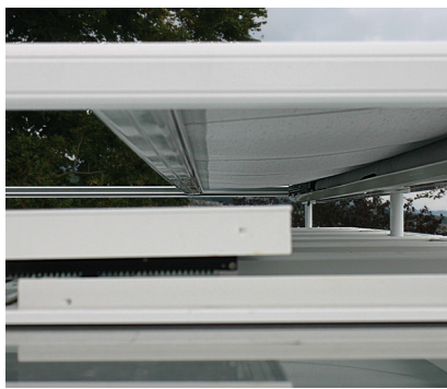
Lüftung unter einer ausgefahrenen Markise
