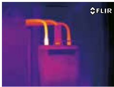
Schlechte Verbindung und innere Beschädigung
