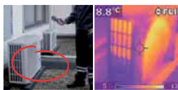
Schnelle und mühelose Überprüfung einer Klimaanlage.
