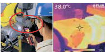
Mechanische Überprüfung eines Elektromotors mithilfe der FLIR i60.
