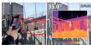
Inspektion des Transformators mit der Fusion-Funktion (Bild-im-Bild).
